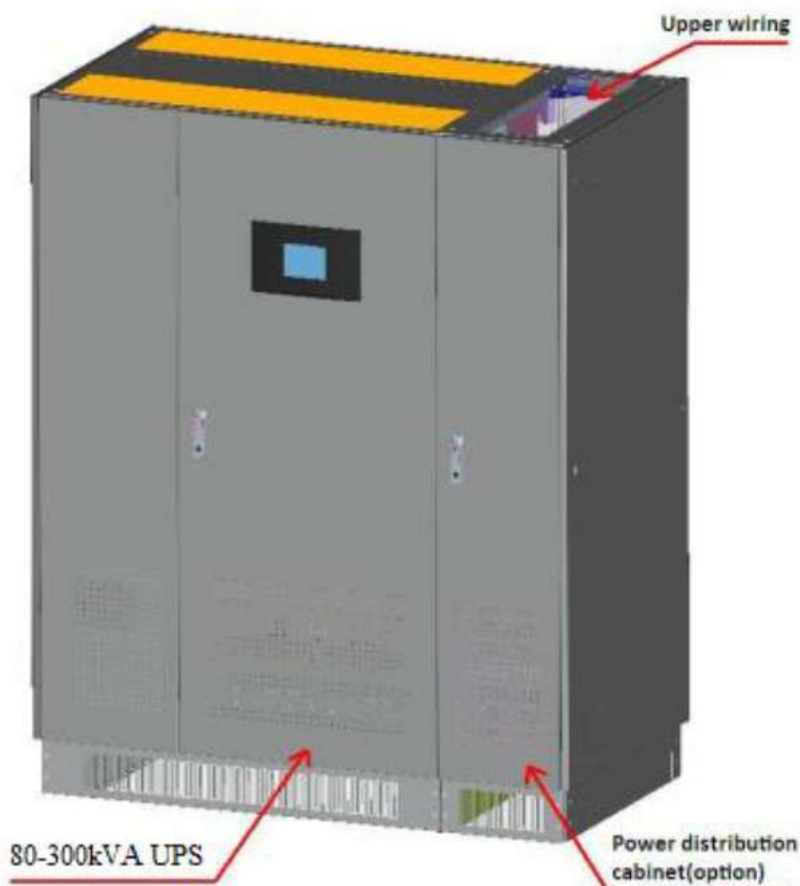
شکل ۳-۲۲: نمودار نصب UPS و کابینت توزیع برق (که می تواند در سمت چپ نصب شود)
